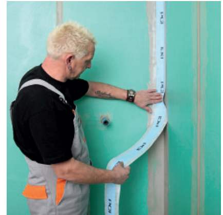
Anschließend wird das Spezial-Dichtband PCI Pecitape 120 mit der Hand ausgerichtet und leicht angedrückt...
