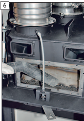
6 Zuluftverteiler reinigen. Ggf. Fremdkörper entfernen.
